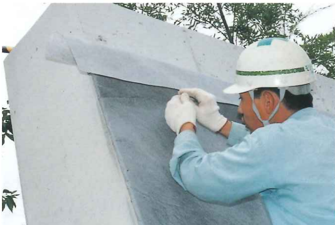
天端部に接着剤を用いて補助フィルターをかぶせ、裏込め土の流入を防ぎます。
