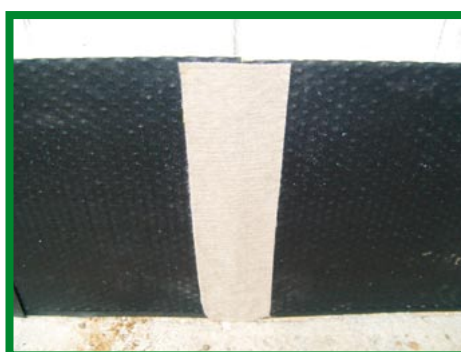
⑧ よこ貼りカルドレーンの切断端部の不織布貼付け 1
