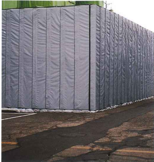
建設土木工事の防音壁
